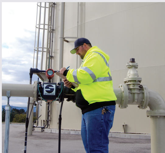
Ininspeksiyon at sinusubaybayan ng Operator ang flow meter sa isa sa mga reservoir ng Distrito
